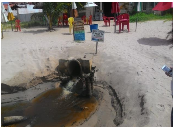
Figura 104, drenagem de água pluvial.
