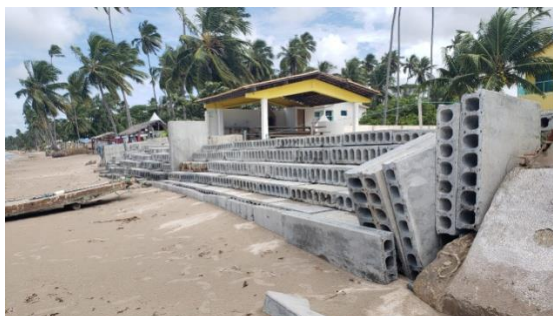
Figura 114, Obra de contenção Irregular.
