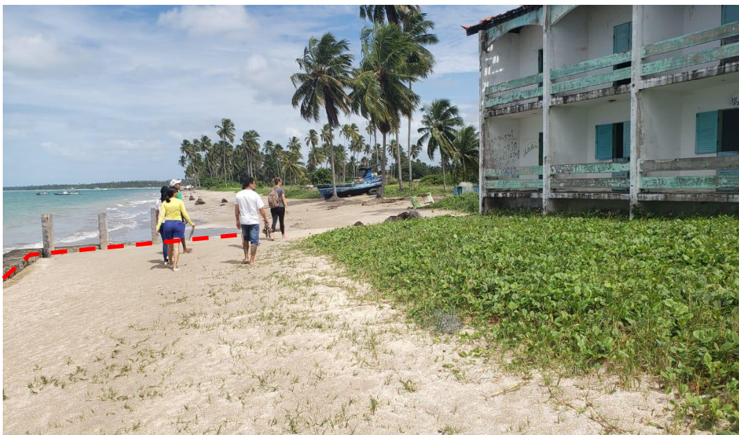
Figura 122, Obra de Contenção irregular avançando sobre a linha d'água.
