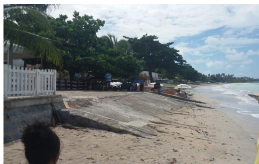
Figura 28, obras de contenção irregulares.
