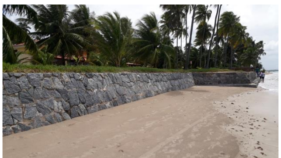
Figura 60, Obras de contenção irregular.
